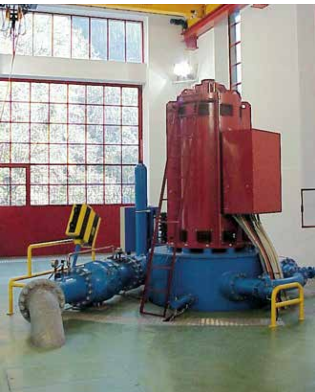
La parte elettromeccanica della centrale è stata completamente automatizzata.
