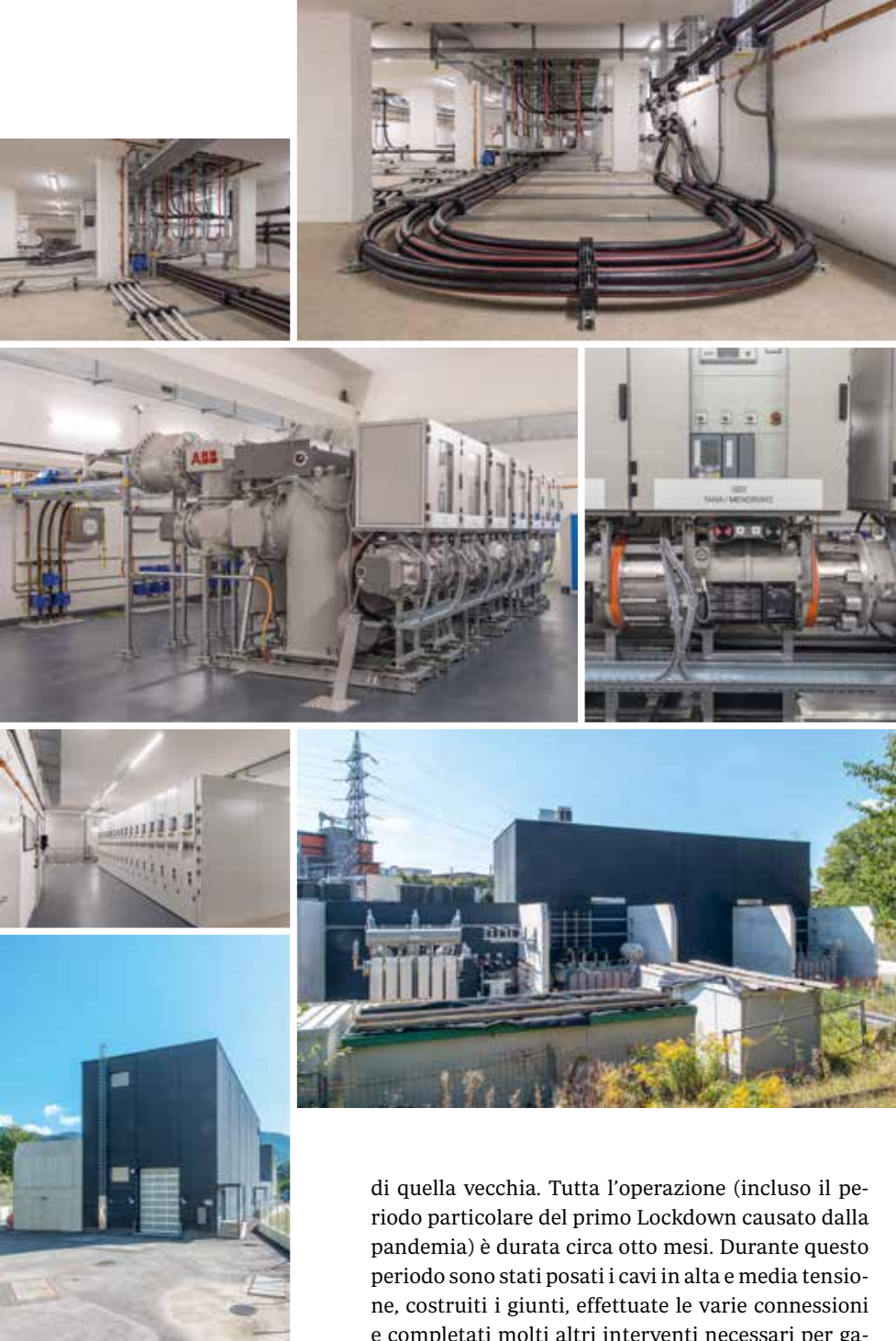
La nuova sottostazione Tana di Mendrisio di proprietà di AIM è entrata in funzione a fine estate 2020.
