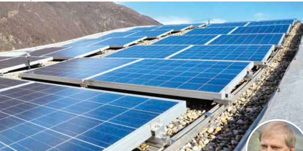
Anche i pannelli fotovoltaici possono godere degli aiuti statali. A destra il Capo del Dipartimento del territorio Caludio Zali.
